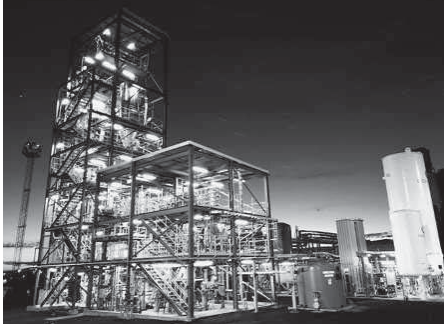
豪州に建設した褐炭ガス化・水素精製設備
